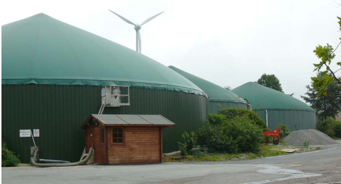
Biogasanlage Quelle: Georg Dicke, Altenmellrich 2011
